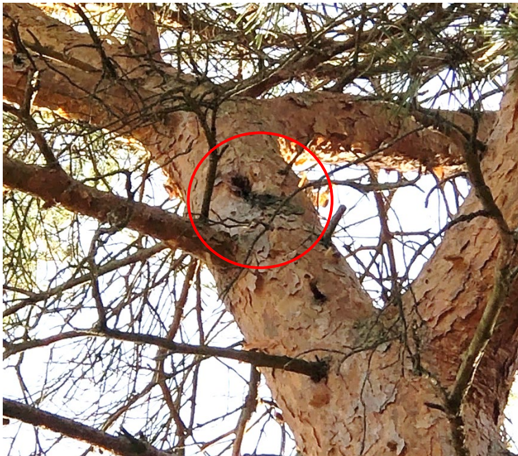
Abbildung 2: Kleines Astloch in Baum Nr. 43 mit dunkler Verfärbung unterhalb (rot umrandet).
