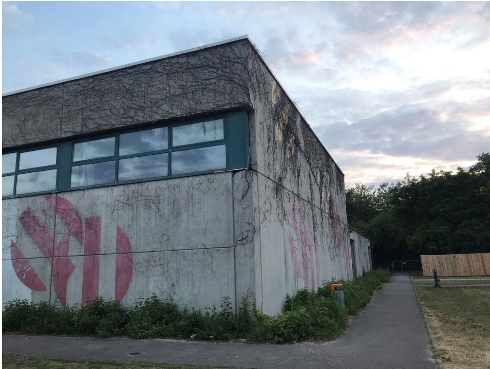
Abbildung 1: Süd- und Westfassade der Turnhalle mit abgestorbener Fassadenbegrünung.
